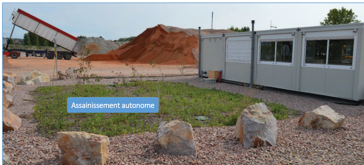
Fig. 14 : Photographies n°7 : Vue sur le dispositif d'assainissement autonome
